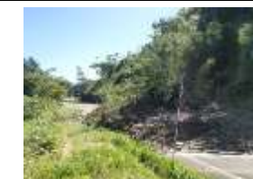
崩土で通行止めとなった市道(復旧済み)
