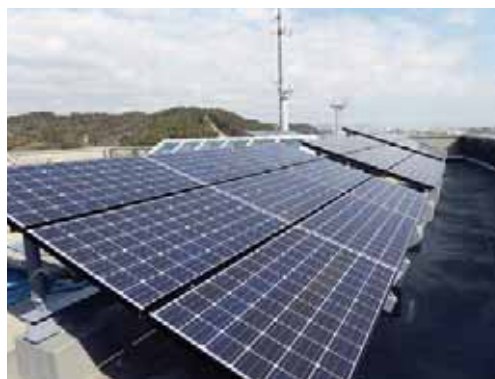
▲太陽光発電(榛原庁舎屋上)
