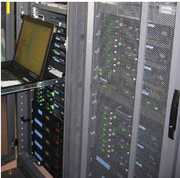
榛原庁舎4階の電算室
