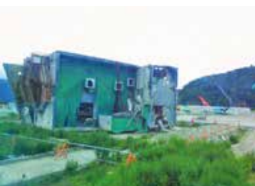
震災時よりそのままの建物
