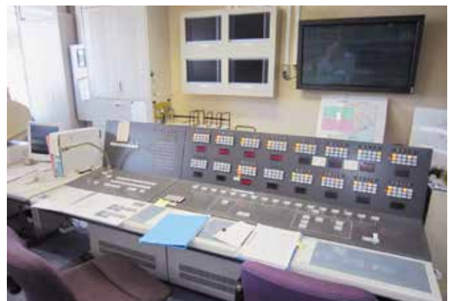
相良庁舎内の「津波・高潮防災ステーション」
