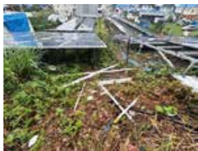
令和7年台風15号の被害を受けた太陽光発電設備
