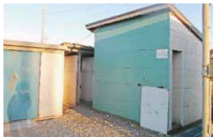
老朽化が進んだトイレの現状
