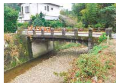
計画的な補修工事を
