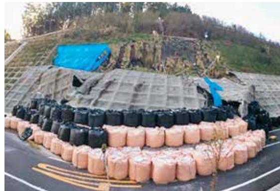
壱丁田北線被災状況
