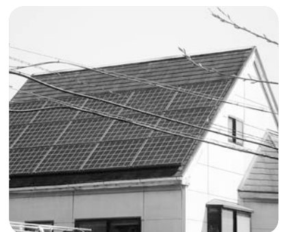
家庭での太陽光パネル設置
