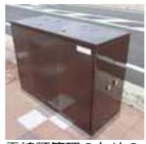
電線類管理のための地上用施設
