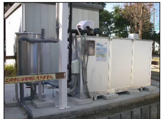
▲雨水利用施設
