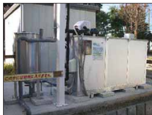
▲雨水利用施設
