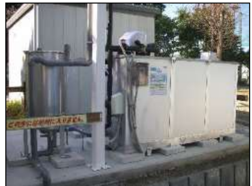
▲雨水利用施設
