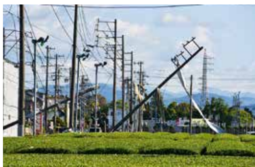
竜巻による被害の様子
