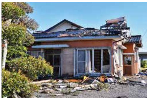
大きく竜巻被害を受けた住家
