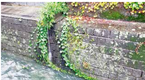
50年余りが経過した都市下水路
