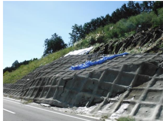
□法枠すべりの状況 (10/23 撮影)
