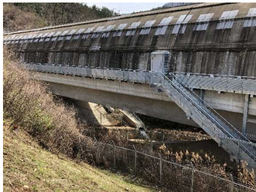
トンネルから流れ出る湧水
