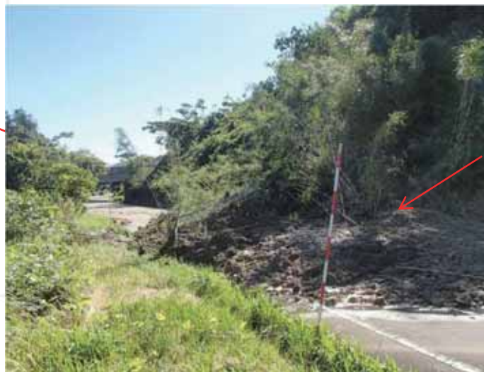
■市道 須々木49号線 土砂災害 通行止め (10/13撮影)
