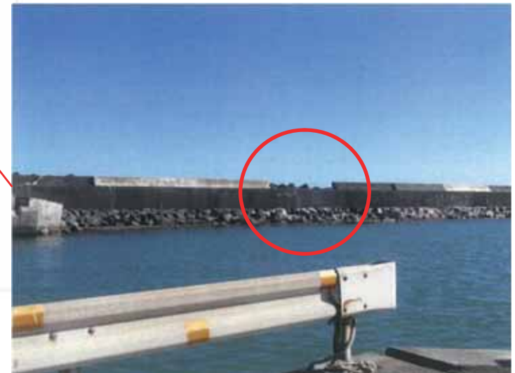
■ 相良港 防波堤 パラペット破損(10/13撮影)
