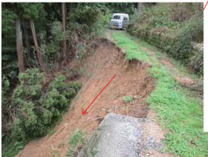
■農道 丸倉農道 土砂災害 (10/13撮影)
