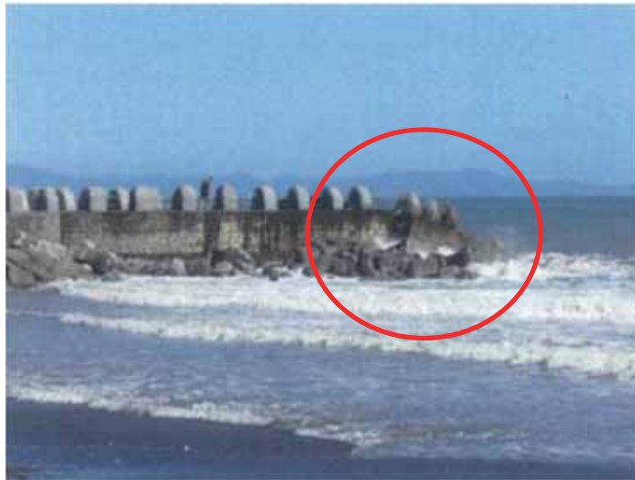
■ 静波海岸 突堤 一部破損 (10/13撮影)
