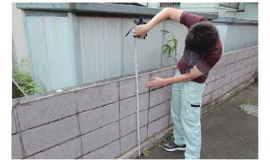
危険なブロック塀は改修・撤去を
