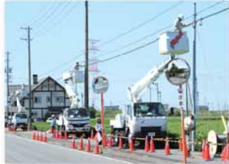
整備率100%へ 「市内光ファイバー網」整備
