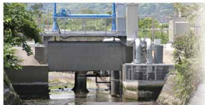
準用河川中条川の排水ポンプ施設
