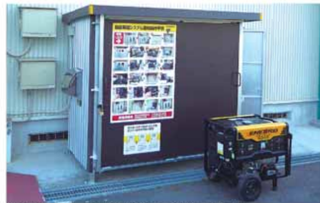
避難所に指定している小学校に自家発電機を整備
