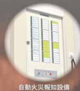
自動火災報知設備
