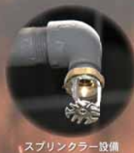
スプリンクラー設備
