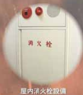
屋内消火栓設備
