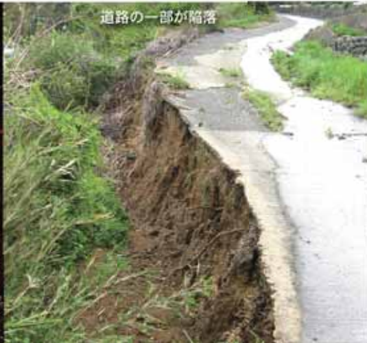
道路の一部が陥落
