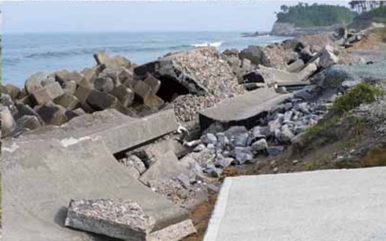
▼津波で破壊された防波堤(南相馬市小高区)
