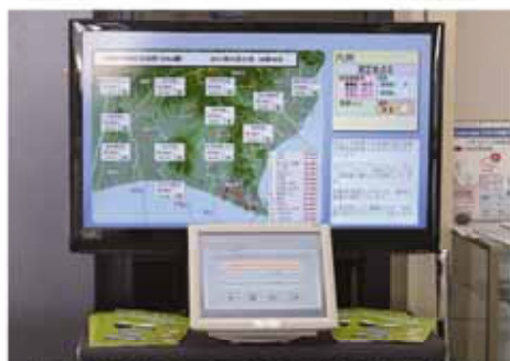
両庁舎にある「タッチパネル付大型表示装置」
