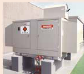
非常用自家発電装置
