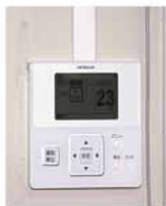
個別の空調機により各部屋での運転操作が可能に
