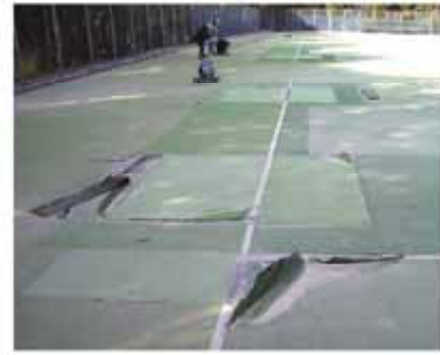
改修前のコート。人口芝がめくれてしまい、ボールの方向が変わってしまうなどの影響が出ていました
