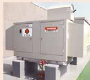
非常用自家発電装置
