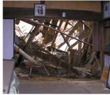
平成21年8月の地震で半壊した家屋
