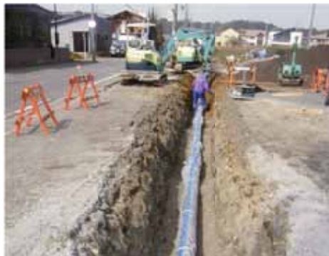
今後も計画的に施設整備を行っていきます （細江1号幹線老朽管改良工事）
