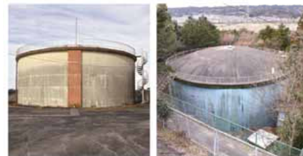
写真右：不動山配水池（給水区域：相良、福岡、波津、大沢、大江、片浜、須々木の一部） 写真左：波津配水池（給水区域：波津の一部）
