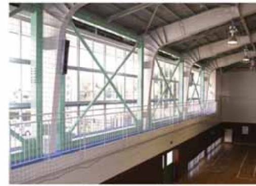
設置された耐震ブレース（筋交い）
