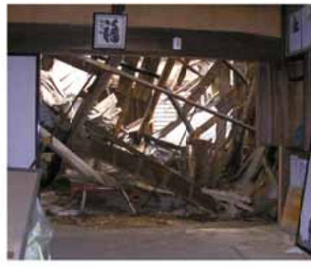
平成21年8月の地震で半壊した家屋
