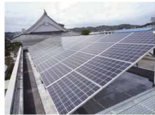
相良庁舎に設置された10キロワットの太陽光発電システム
