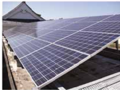
相良庁舎に設置された太陽光発電設備
