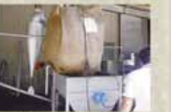
チップボイラー
