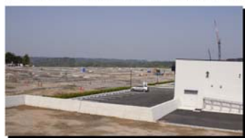
旅客ターミナルビル前には無料駐車場の工事も進んでいます
