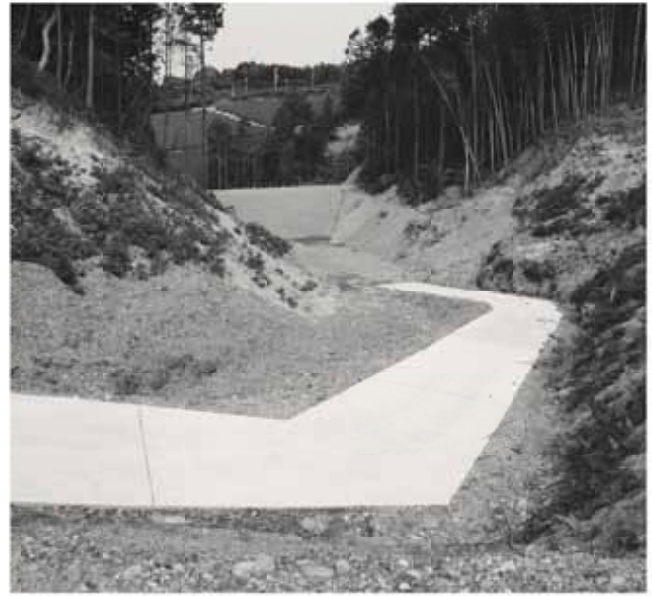
【完成】搬入路も含め整備された橋柄がれき処分場。5月1日から使用可能となっています
