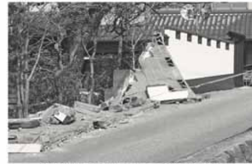
壁の倒壊により、車両の通行が困難に
