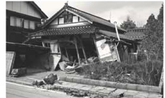
筋交いがなく倒壊した家屋
