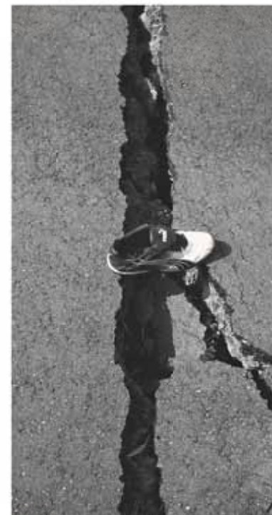
地震により亀裂が入った道路
